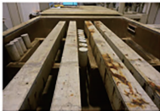
塩分により鉄筋腐食したはり
