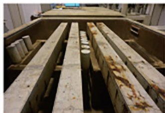
塩分により鉄筋腐食したはり
