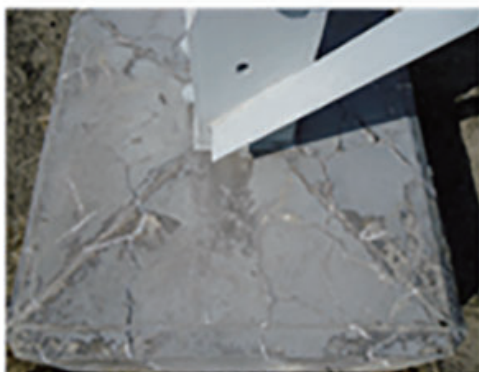
ASR 損傷を受けた鉄塔基礎
