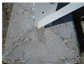
ASR 損傷を受けた鉄塔基礎
